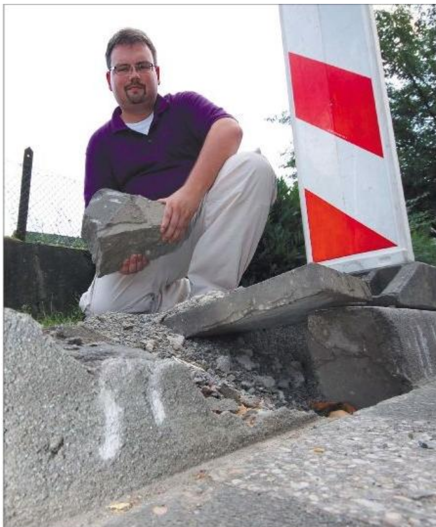
An dieser Stelle der Kirchborchener Straße haben | Patrick Knüttel zeigt ein Stück des Bordsteins, den die tonnenschwere Panzer den Gehsteig aufgerissen. | Kettenfahrzeuge mit ihrem Gewicht zerstört haben.
